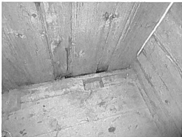
Råteskade i tårnet.
